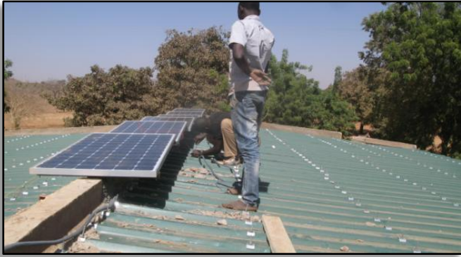
Die Solaranlage der Werkstatt
